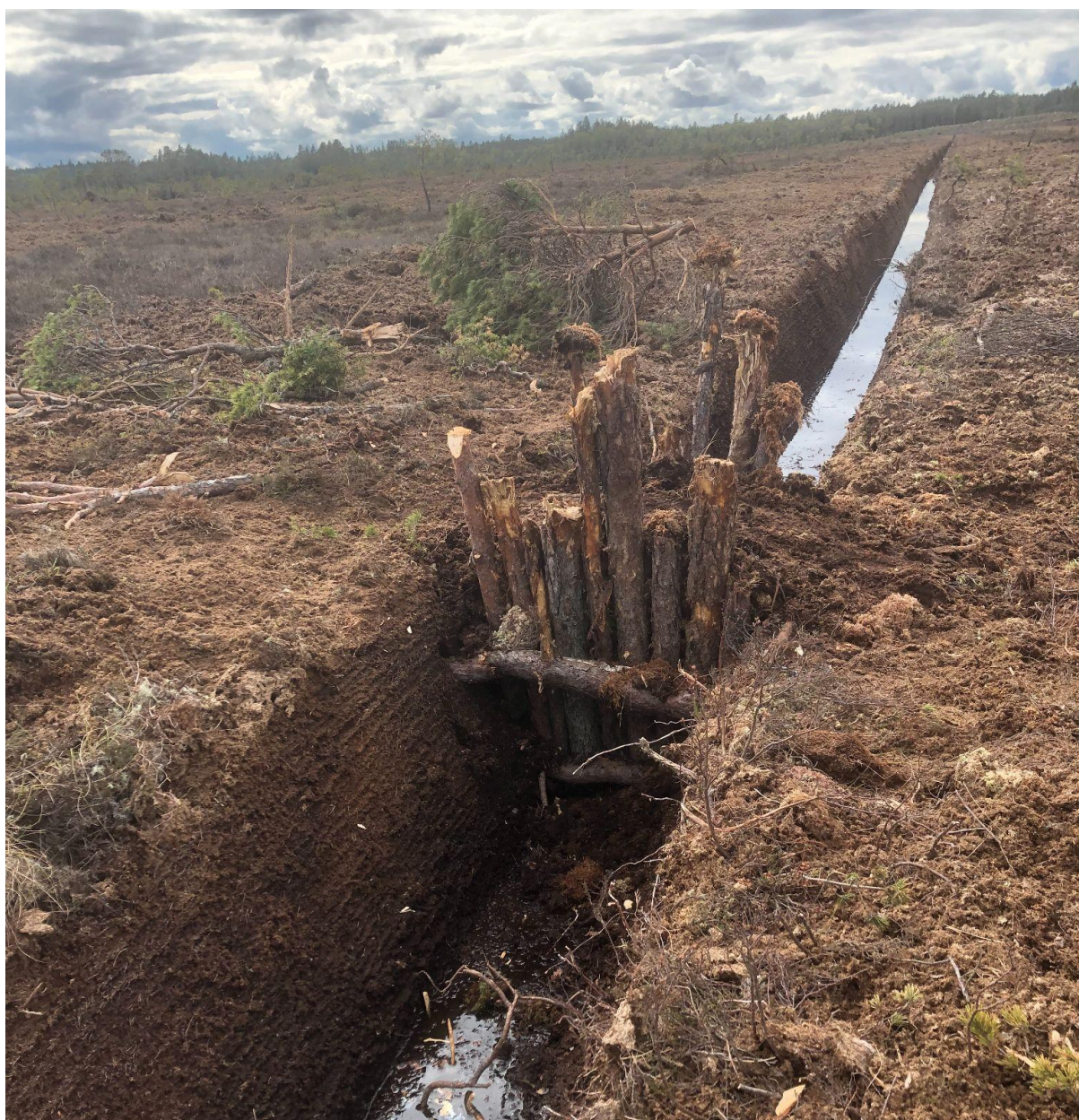
En av våra pluggar där man tydligt ser att vattnet stoppas upp.
